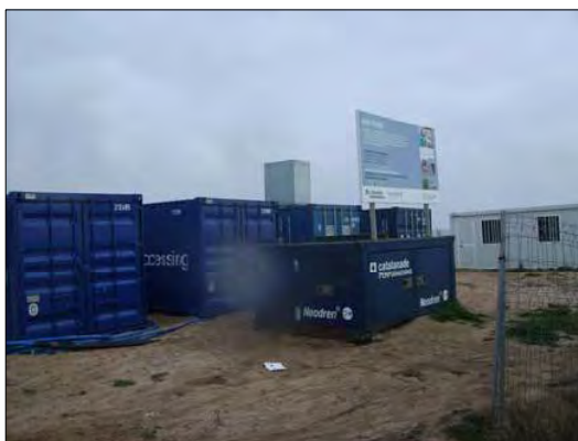
Estación de bombeo, contenedores de pretratamiento y planta piloto ósmosis inversa
