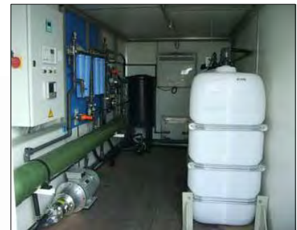
Planta piloto de ósmosis inversa
